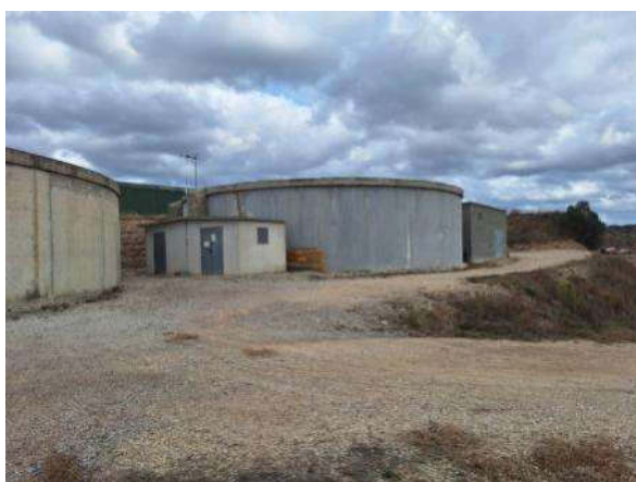
Diferents instal·lacions d'emmagatzematge d'aigua
